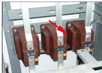
Bild 12 defekter 20 kV Wandler
