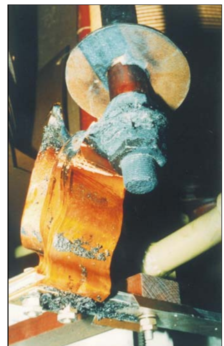
Bild 6 Schaden an einem 110/10 kV Transformator durch Überhitzung
